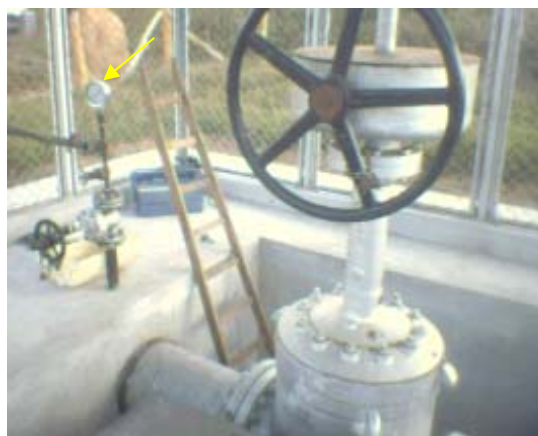
Figura 2. Manômetro instalado no by-pass
